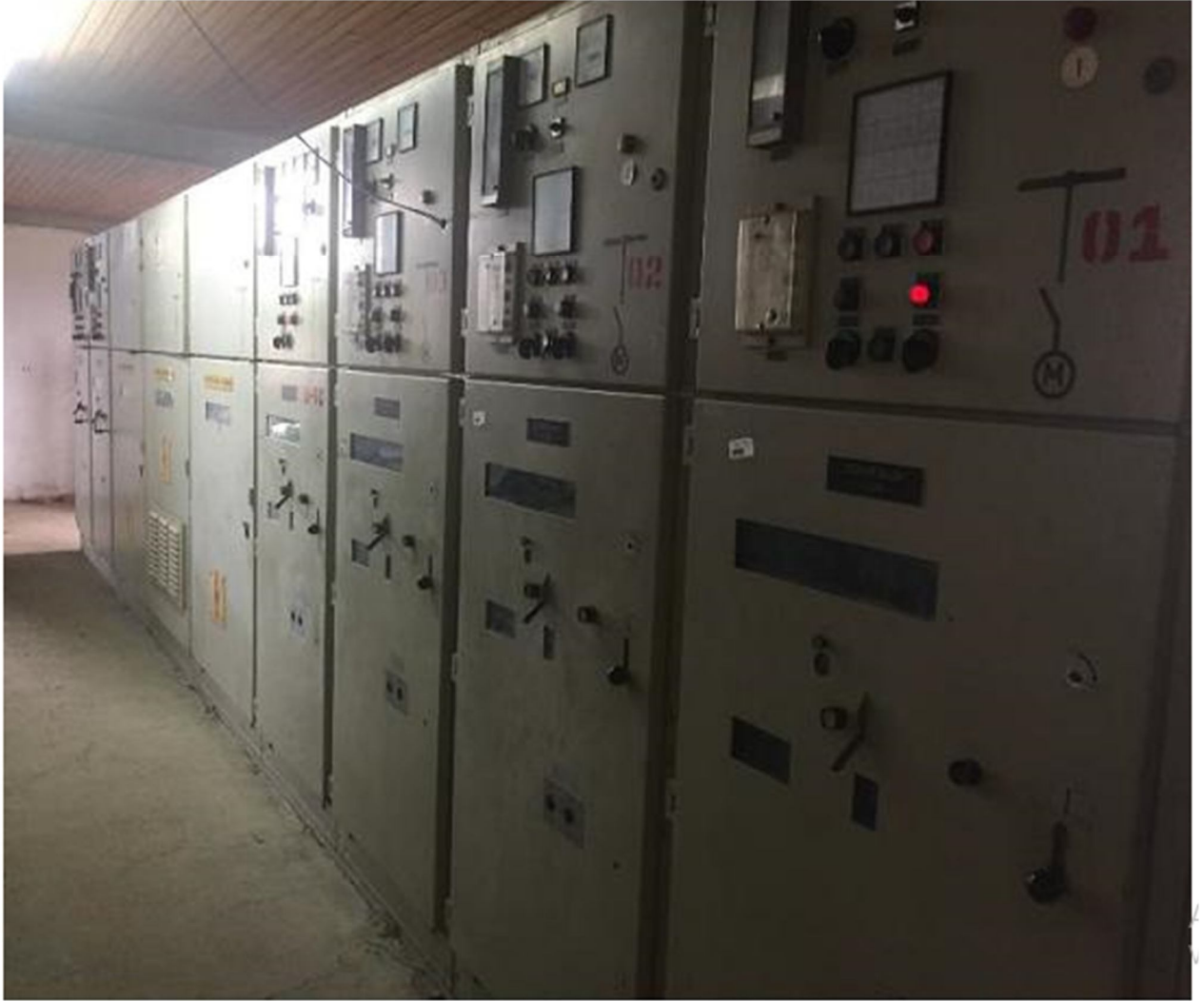
CELDA 8BK20 ESTACION DE BOMBEO DOÑA NIDIA
